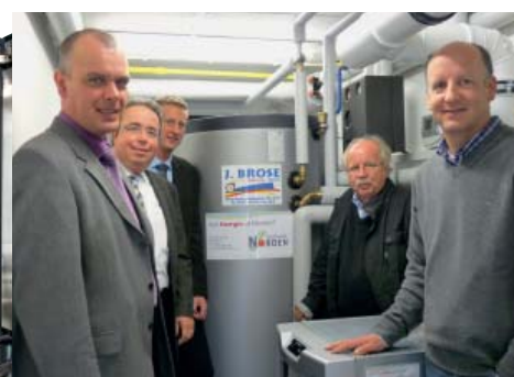
Mini-Kraftwerk im Keller: Wolfgang Völz, Stefan Richtstein und Florian Hertrampf von den Stadtwerken Norden weihen das kleine BHKW im Keller von Paul und Joachim Brose (v. l.) ein.
